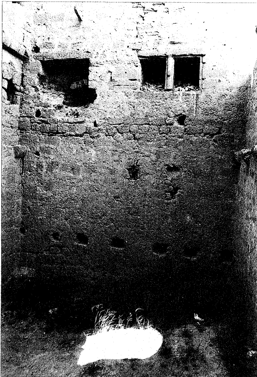
Lam. 9. Castillo de Quel. Torre. Detalle de la parte inferior del muro oeste.
