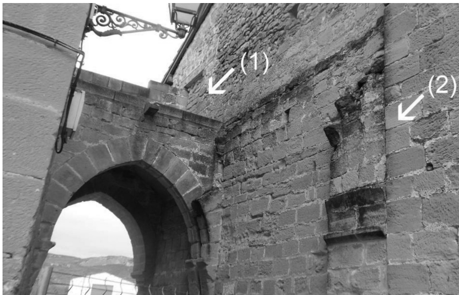
Figura 19. Muro occidental de la iglesia: (1) acceso al adarve tabicado y (2) arranque de un último arco.
