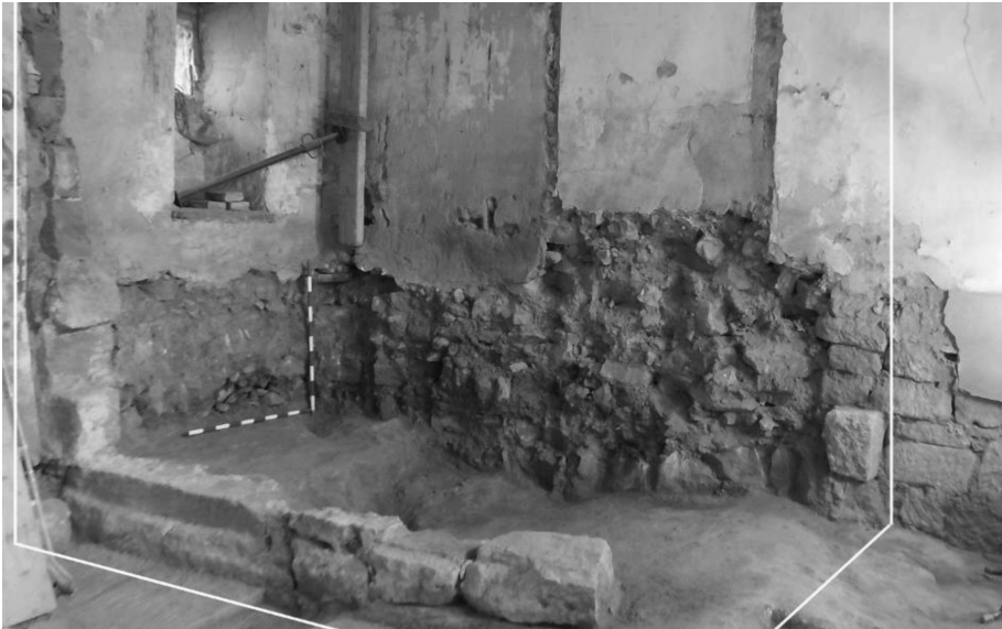
Figura 10. Restos de la camisa de sillares de la torre una vez retirado el relleno interior.
