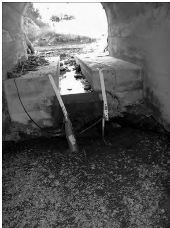
Figura 2. Detalle de la estación de aforo instalada en la cuenca de Araguás
