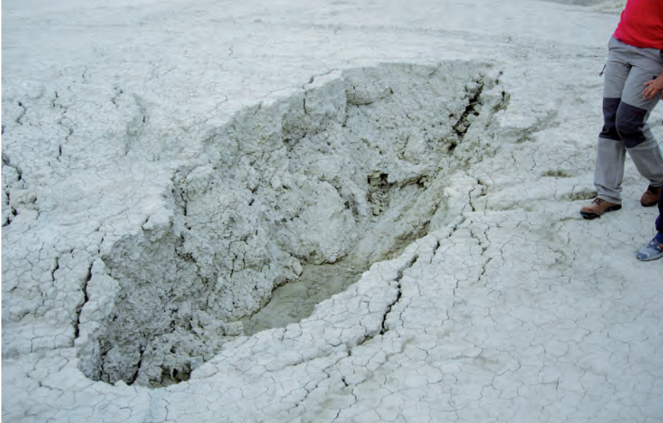
Figura 5. Inicio de colapso en el rellano de un campo abandonado en la cuenca de Mula. Puede deducirse el elevado contenido en margas del suelo.
